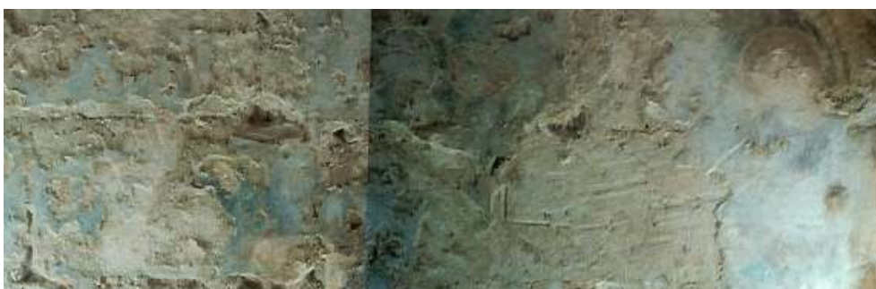
Détail d'une zone avant traitement.
