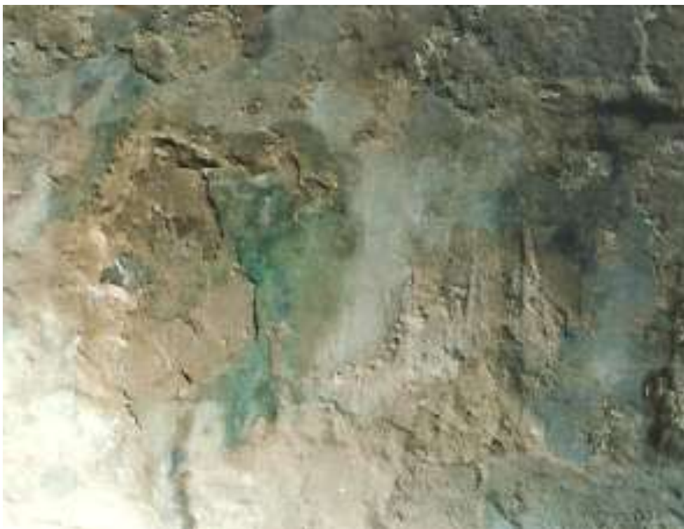
Zone d'enduit non adhérent après refixage.
