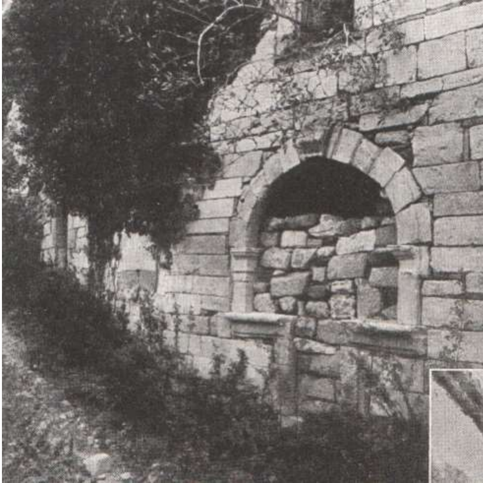
Envahies par le lierre, les herbes et les branches d'arbre, les murailles menacent ruine.
