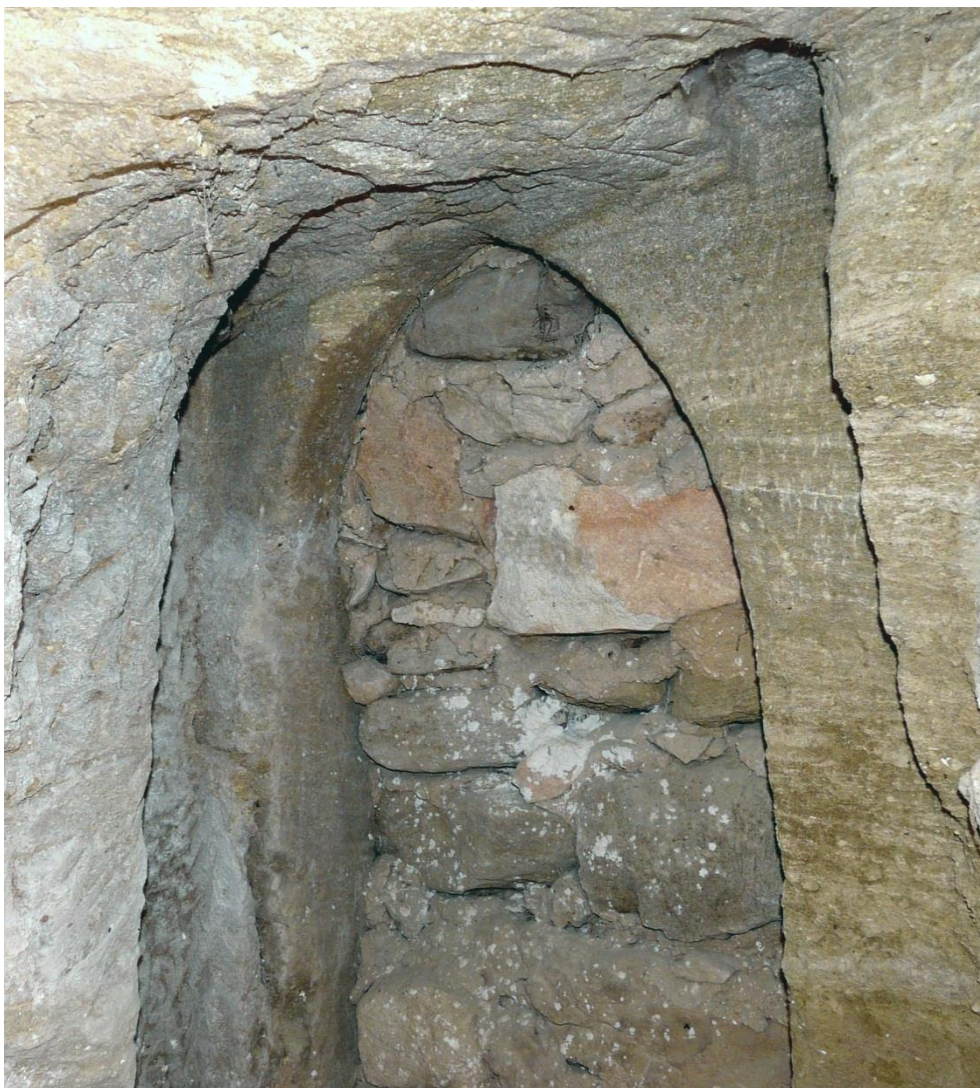
Fig. 20 : La fenêtre murée avec arcs d'ogive.
