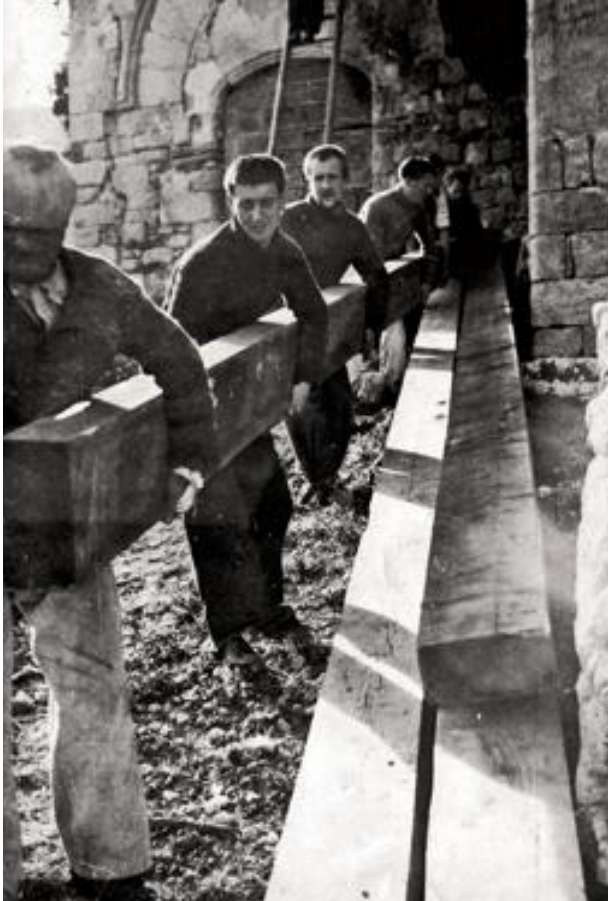
La restauration du prieuré du XIII e siècle par les membres du groupe d'Oppède, avec l'aide du maçon du village. A gauche, Le Petit Café.
